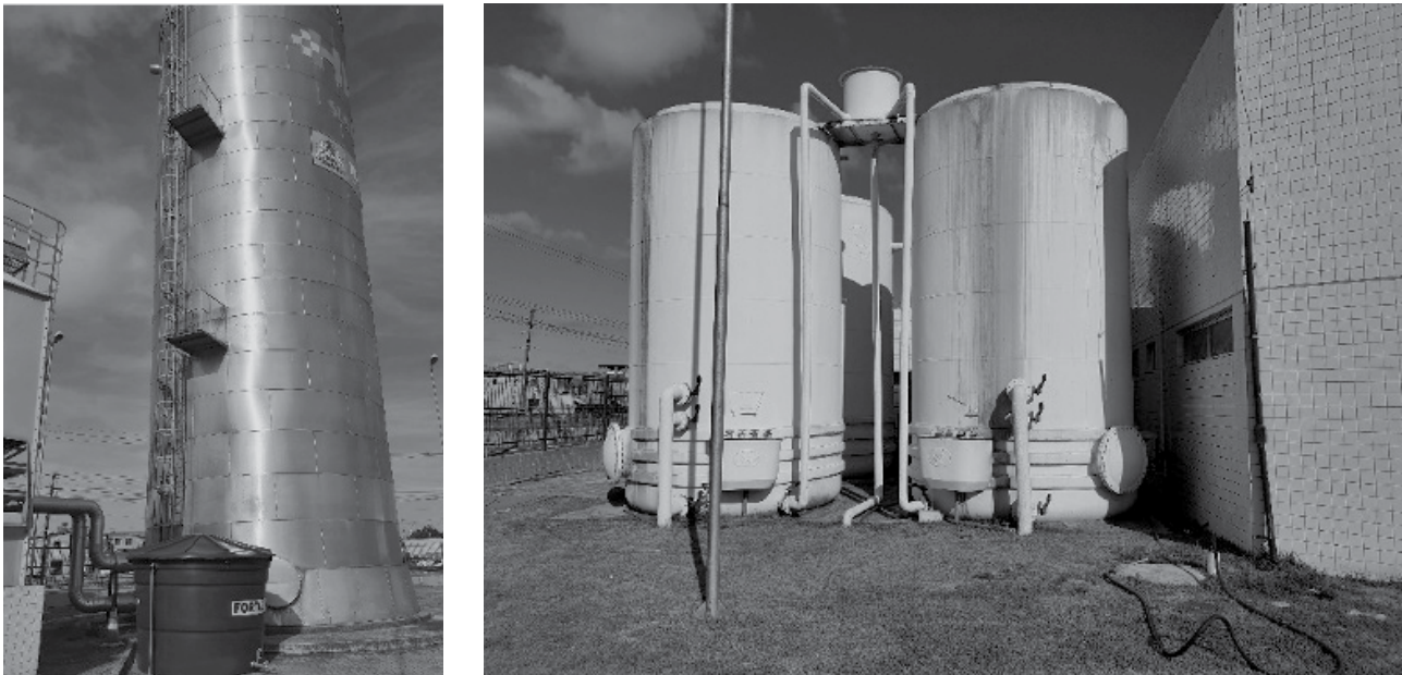
Figura 13. Foto da torre de termoacumulação (esquerda) e da estação de tratamento de esgoto do HMR (direita). Fonte: Consultorias, 2020
